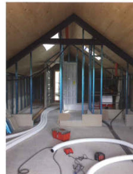
Costruzione di una Passive House in struttura mista: muratura armata, calcestruzzo armato, legno, acciaio.
