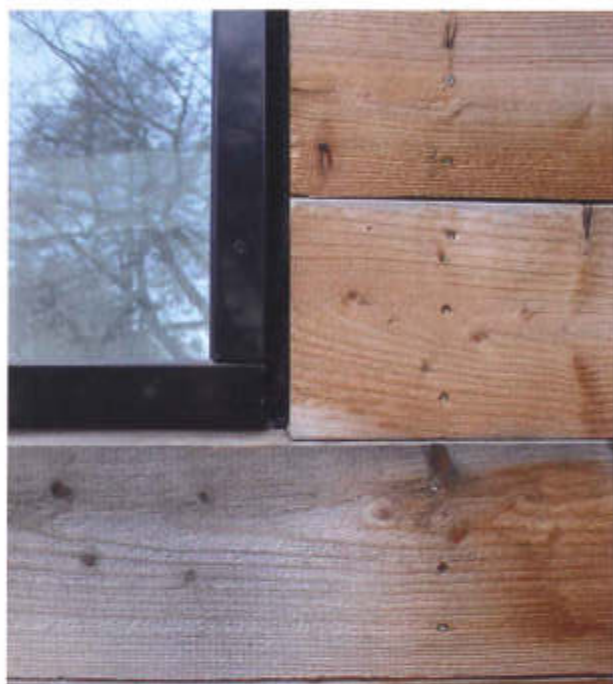
Residenza a Dortmund: dettaglio del processo di autoprotezione del legno e conseguente desaturazione del colore originario
